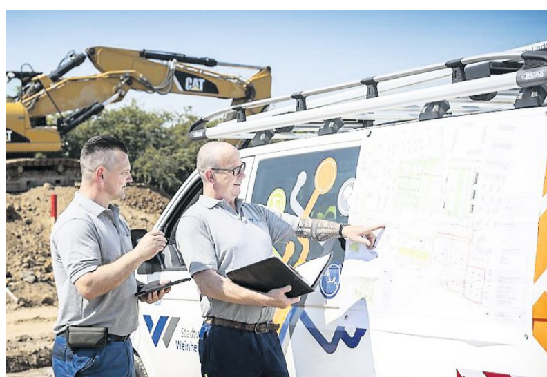
Die Experten von den Stadtwerken Weinheim wissen genau, wo welche Leitungen liegen. Die Daten sind nun auch online abrufbar. BILD: STADTWERKE WEINHEIM
